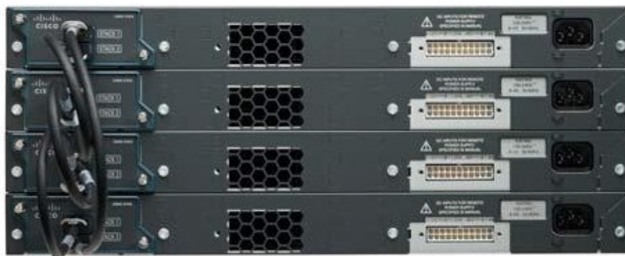
Рисунок 3.6 – Коммутаторы Cisco Catalyst 2960-S с модулями Cisco FlexStack и кабелями стекирования
